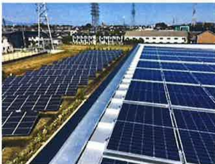
▲171.5kWの太陽光発電装置
