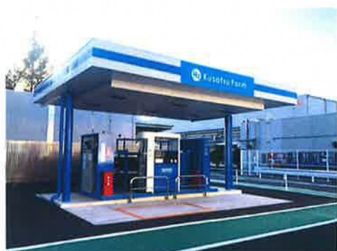
▲工場内の水素ステーション
