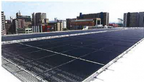
▲太陽光発電による電気を供給
