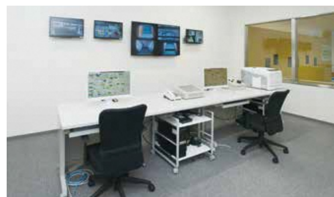
中央制御室 施設全体の処理ラインを管理します。機器の状態や処理の状況をモニタなどで監視し、安全で効率の良い運転を行います。
