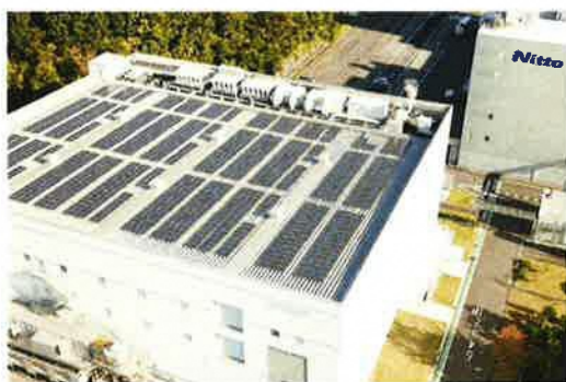
▲太陽光発電を設置
