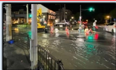
【令和5年度に草津市内で発生した水道管漏水事故】
