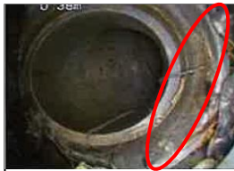
流水プール排水管 管の破断脱落
