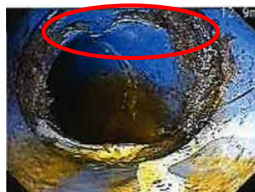
更衣室排水管 腐食による上部欠損
