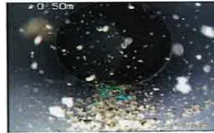
流水プール配水管 堆積物による滞水（原因不明）
