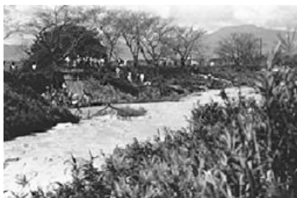
図 1-8 台風13号により決壊した堤防
