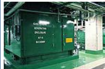
非常用発電設備室
