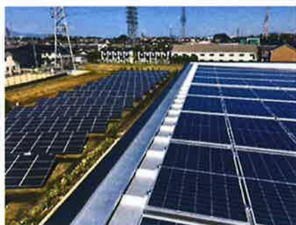
▲171.5kWの太陽光発電装置
