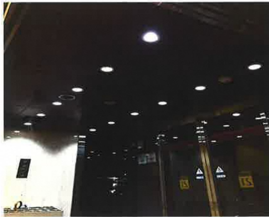
◀入口のLED照明
