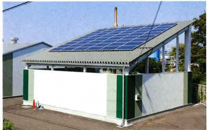
▲太陽光パネル
