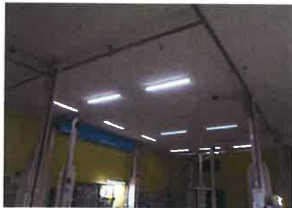
▲LED照明 (工場)
