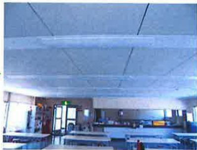
LED照明 (厚生棟)
