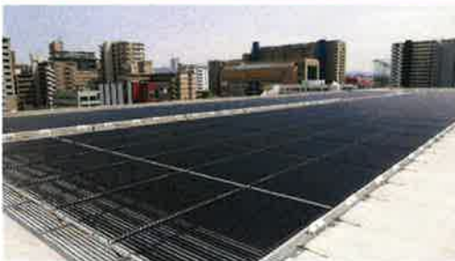
▲太陽光発電による電気を供給
