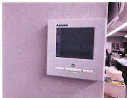
空調温度設定の管理▶
