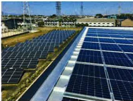
▲171.5kWの太陽光発電装置
