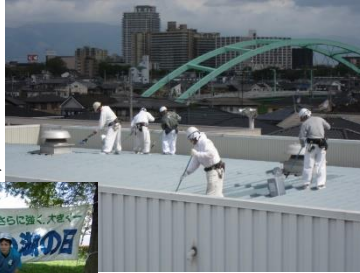
<遮熱塗料塗布による省エネ>
