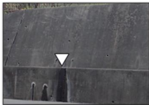
地下水の流出
