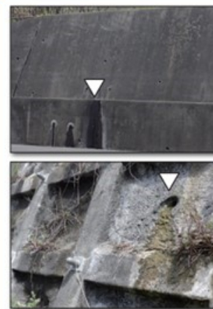
地下水の流出
