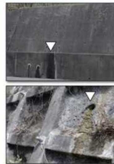
地下水の流出
