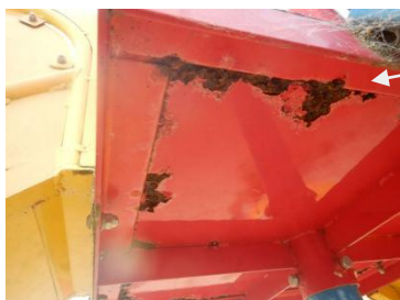
複合遊具 踊場裏面腐食
