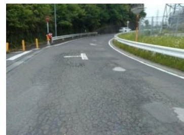
<事後保全> 舗装老朽化 舗装点検判定Ⅲ～Ⅳ
