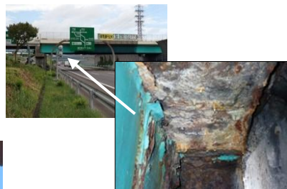
<予防保全> 床版腐食(玉川橋) 橋梁点検判定Ⅱ
