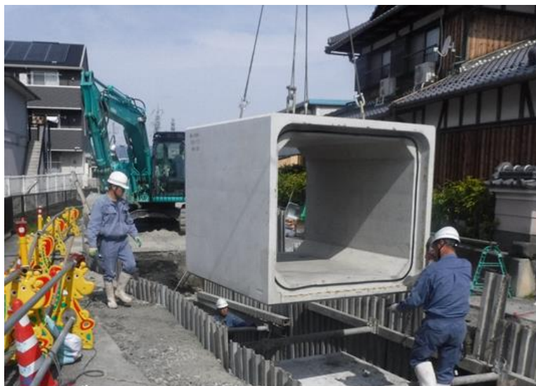
図表 3-8 雨水幹線整備の状況
