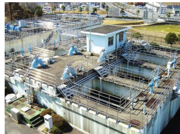
ロクハ浄水場新館
