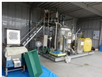
北山田漁港に設置された実験プラント
