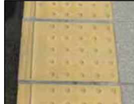
プラットホーム縁端警告用内方表示ブロック
