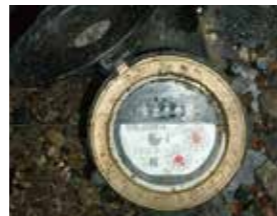
水道メーター
