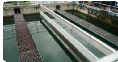
薬品沈でん池
