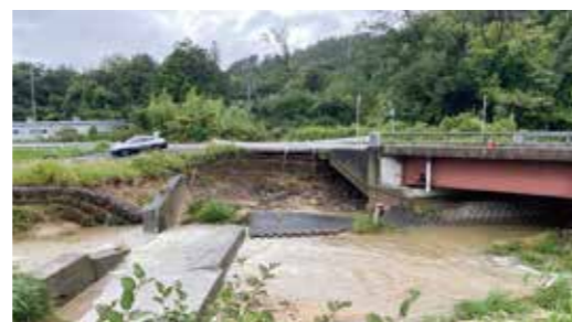
2021(令和3)年 草津市土砂災害
